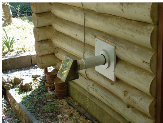
ストレート配管の例（外）
